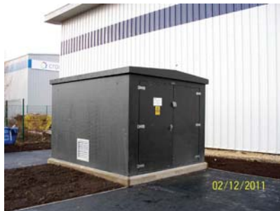
Ring-main Unit/ HV Enclosure
